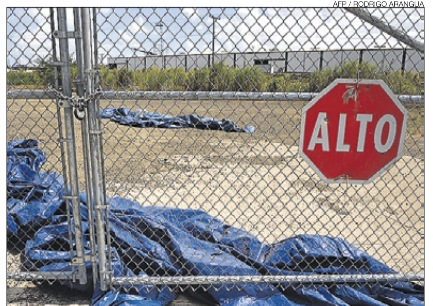
► Acceso cerrado a la zona del material de las obras del canal, el jueves.
